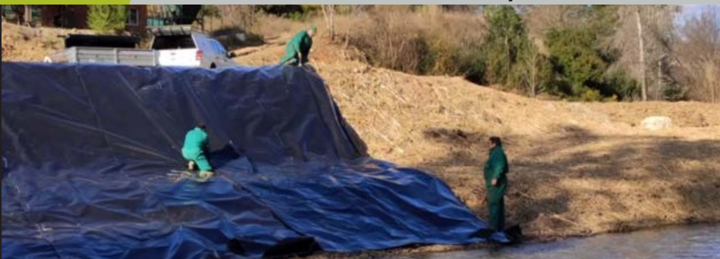
Instalación de cobertura opaca para el control de cañaverales en el río Turia (Chulilla, Valencia). ARCHIVO INVASORAS
