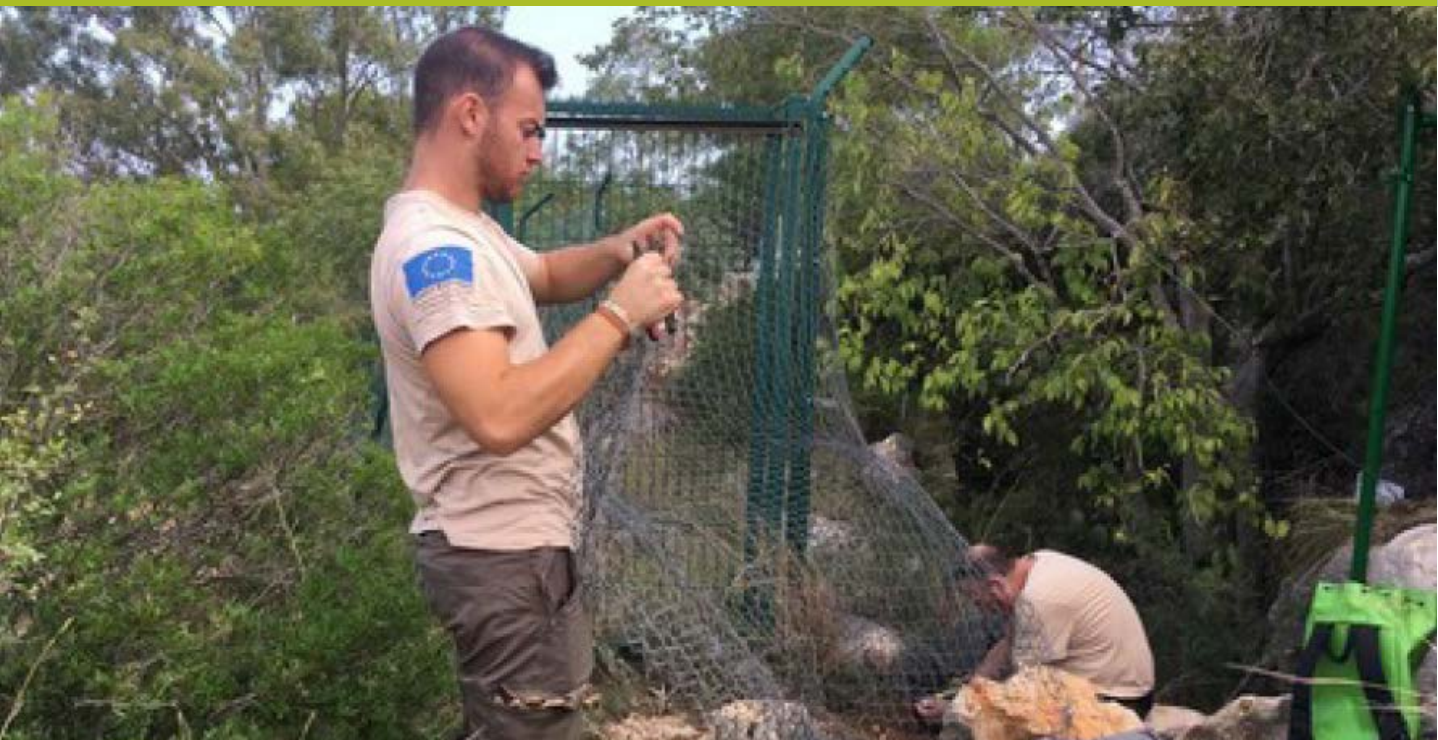
Reparación de la valla de protección para murciélagos en la cueva de la Punta de Benimàquia (Dénia, Alicante). ARCHIVO BN2000
