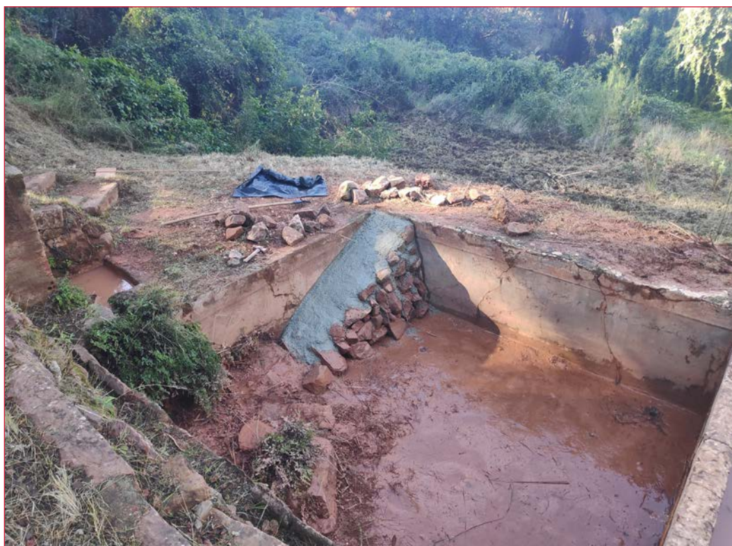
Una de las actuaciones de adecuación de balsas de riego dotadas con dispositivo antiahogamiento. ARCHIVO CRFLG.
