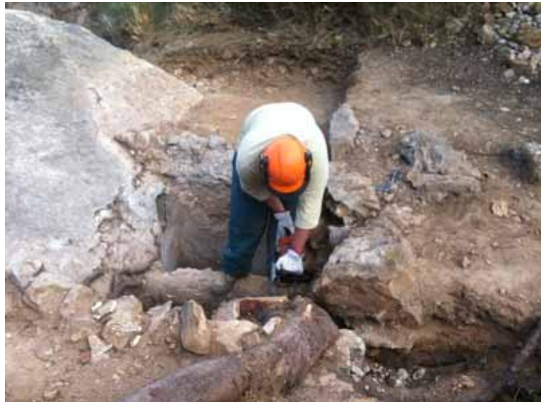
Figura 22. Trabajos de adecuación de zonas de U.P – ruta roja. Fuente: Conselleria d'Infraestructures, Territori i Medi Ambient
