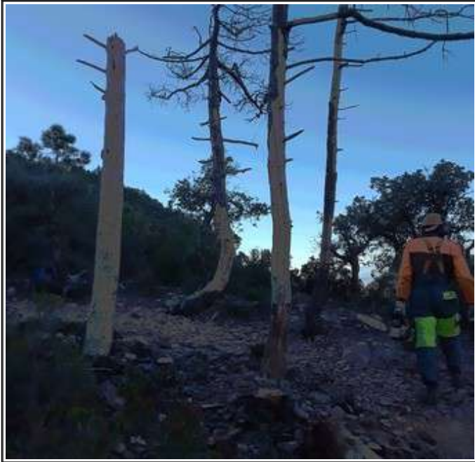
Tallada de pins perillosos en la pujada al Gorgo de la ruta verda del Parc Natural (Gàtova)
