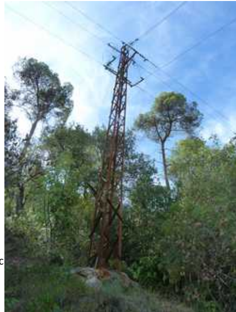
Detalle del punto de entronque de la línea eléctrica en el Barranco de l'Infern
