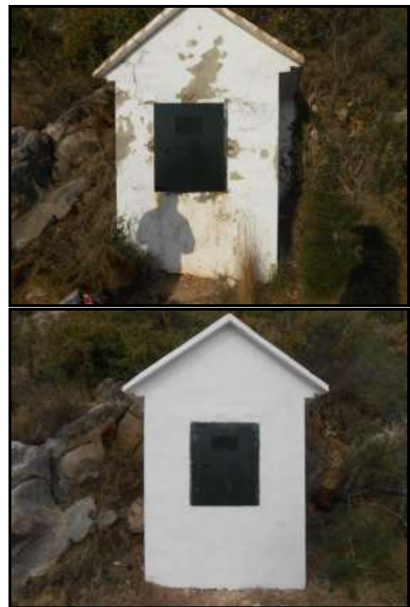
Figura 15: Estado del aljibe antes y después de la restauración
