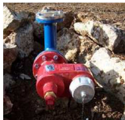
Figura 94. Ejemplo de hidrante perimetral.
